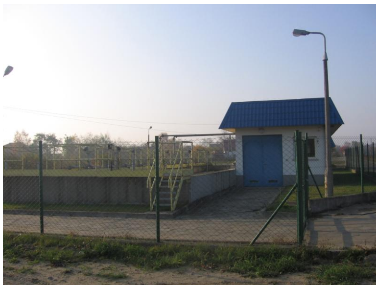
Rysunek 31 Gminna oczyszczalnia ścieków w miejscowości Czernikowo
